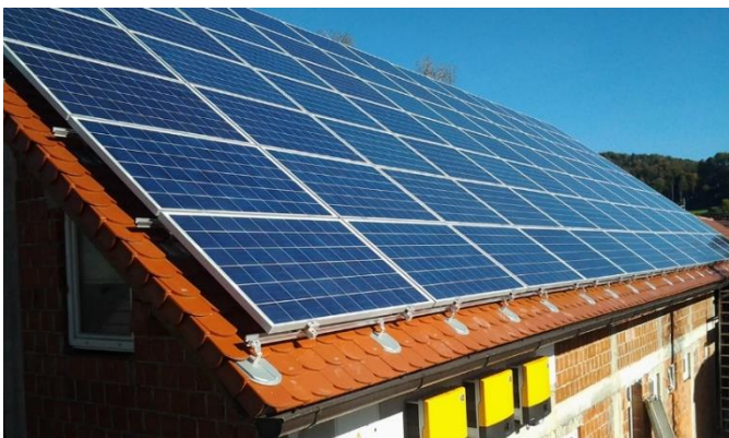
Slika 8: Primer sončne elektrarne na strehi MFE Rupar [19]
