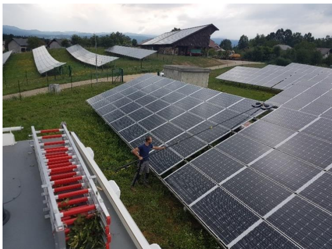
Slika 23: Prikaz čiščenja sončnih modulov s setom iSOLAR 800 in s pomočjo gasilskega vozila [27]
