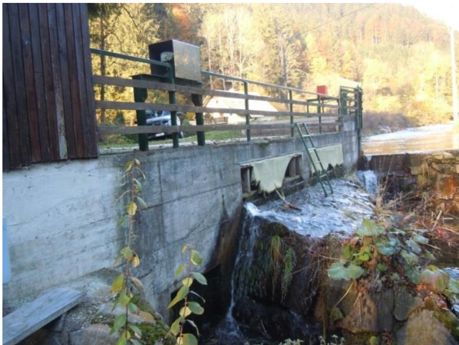
Slika 21: MHE Mislinjski jarek, strojnica Vir: Lasten vir (21.10.2012).
